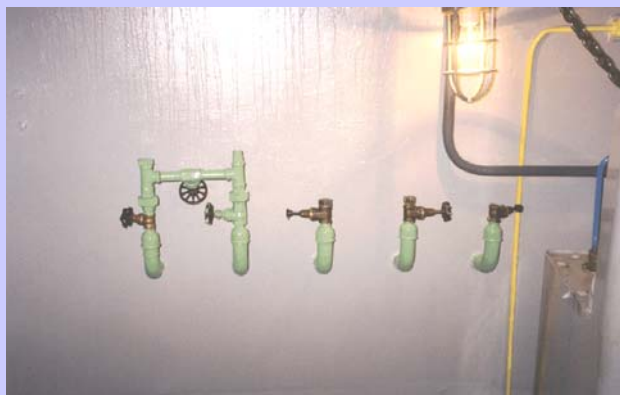
Captação de Pressão na Caixa Espiral
